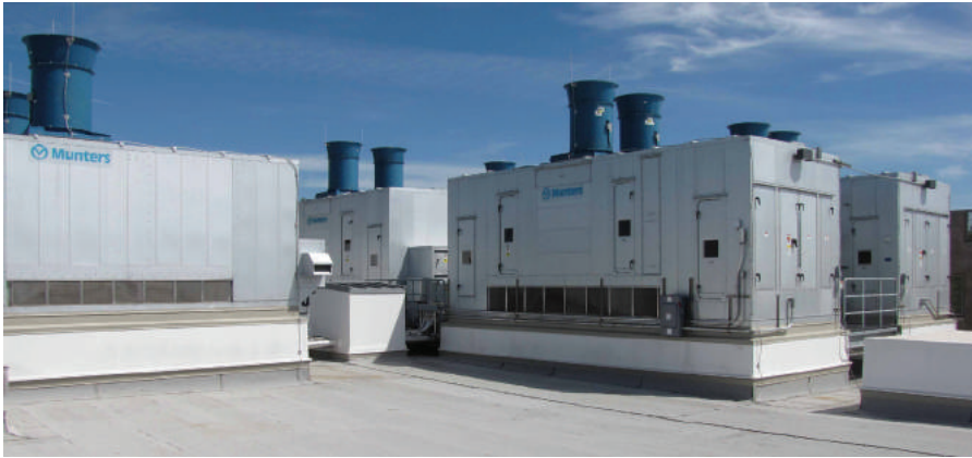
스웨덴의 기업인 문터스는 제습냉방 분야를 선도하는 기업이다. 많은 기업들이 제습냉방시스템을 채용해 비용을 절감하고 있다. 특히 열 발생원이 많고 서늘한 온도를 유지해야 하는 데이터센터나 서버실에서 제습냉방시스템의 활용도가 높다. 사진은 멘터 그래픽스사의 데이터센터에 설치된 제습냉방시스템. © Munters
