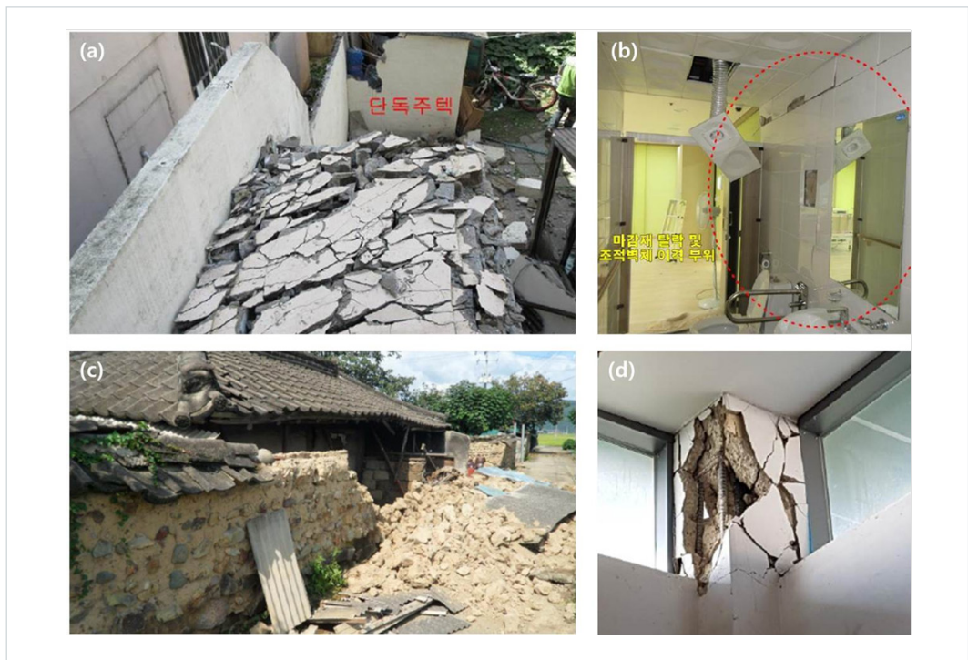
그림 1.1 경주지진 시, 건물의 손상: (a) 난간의 붕괴; (b) 비구조체의 탈락; (c) 토석담의전도파괴; (d) 기둥의 전단파괴 [1]
