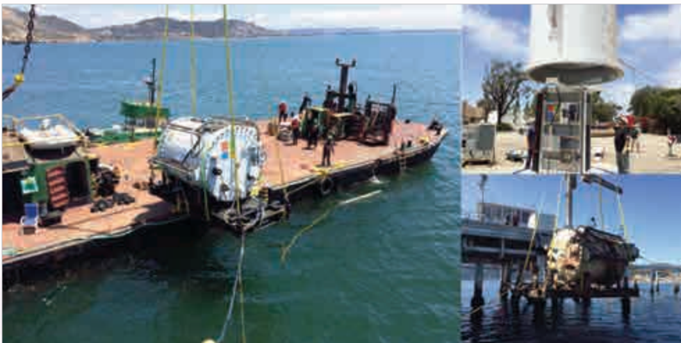
그림 4. 2016년 마이크로소프트 연구소가 설치 및 시험 운행중인 수중 데이터센터 모습
